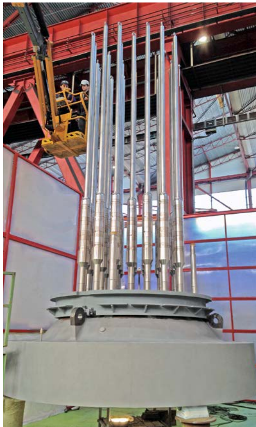
Neuer RDB-Deckel mit Durchführungsrohren. Foto: KKB
